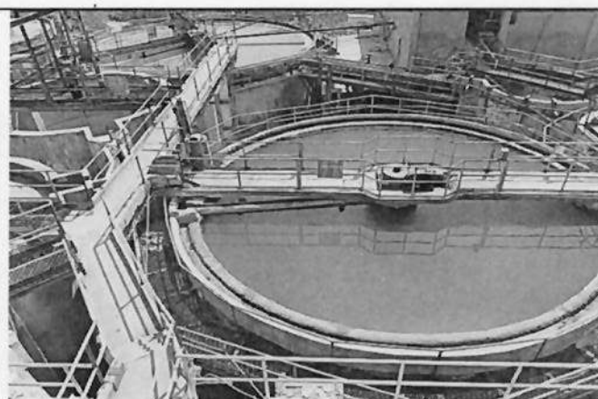
Effluent treatment plant (ETP)
